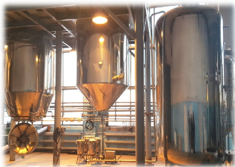
Цех по производству инокулянта «БиоБeСтА» в компании АО «Аметис»
